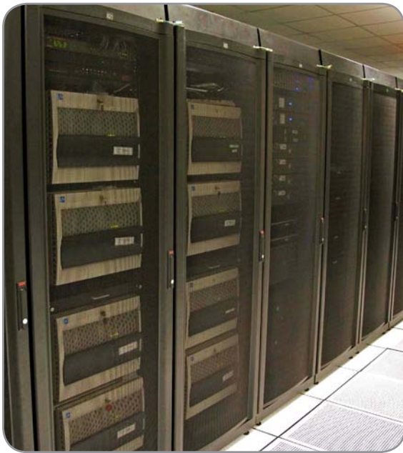
UNIMAS Data Centre
